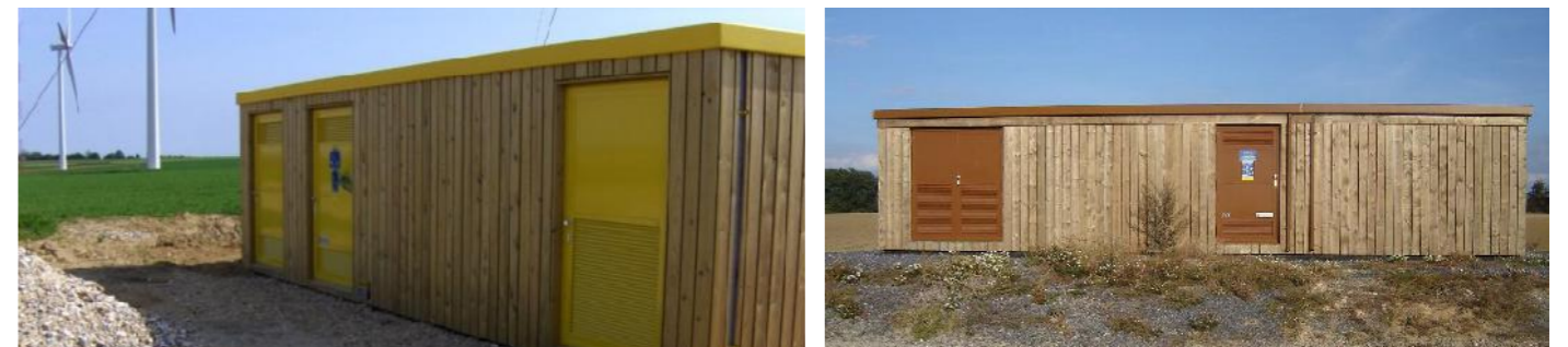
Fig. 395 : Exemples de postes de livraison habillés en bardage bois vertical
